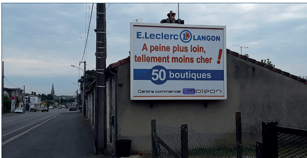
Dépassement du mur
